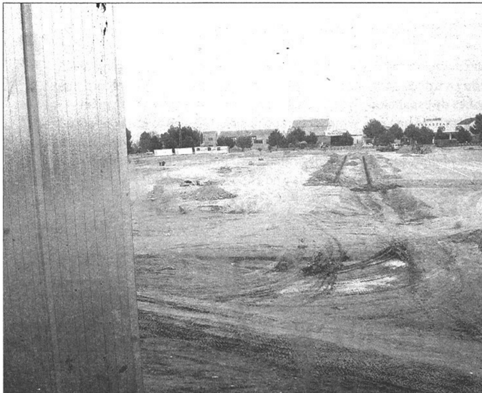
Desde hace semanas se realizan los trabajos de urbanización del entorno del Palacio.
